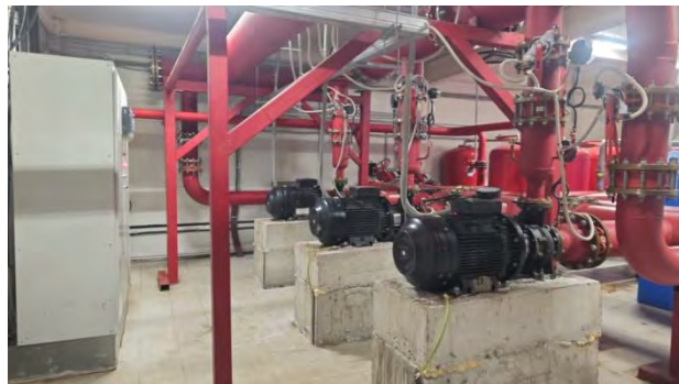
Фото № 30. Насосная станция пожаротушения
