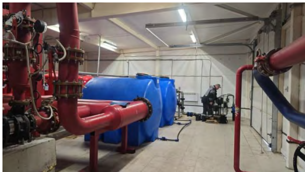
Фото № 29. Насосная станция пожаротушения
